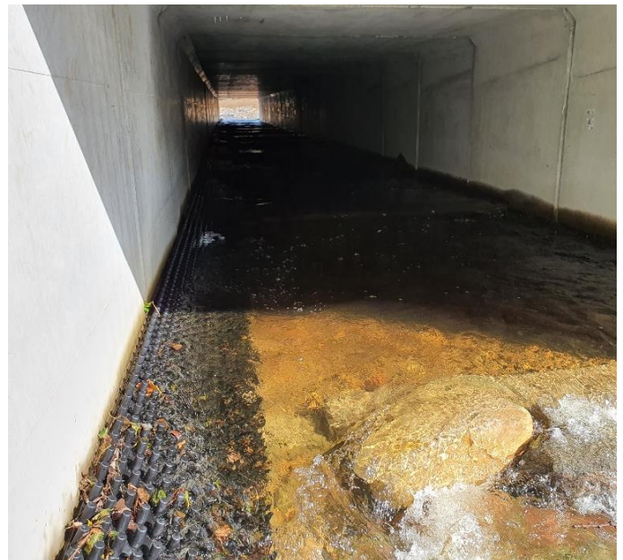
Mae cwlfer Afon Rhyd yn cynnwys bafflau pysgod a matiau llysywennod ifanc i ganiatáu i bysgod a llyswennod mudol fudo i fyny'r afon.
